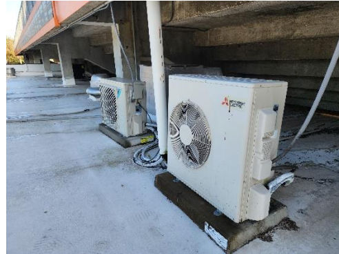
C14: Mini Split Condensing Units
