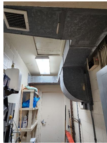
C8: Exhaust Fan Ductwork
