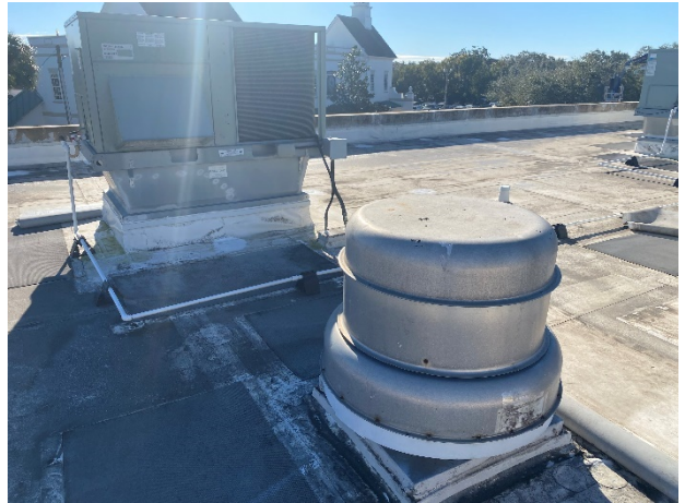
C-14: Rooftop Exhaust Fan
