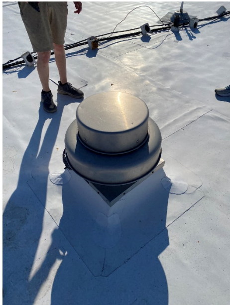
C-9: Rooftop Exhaust Fan (1)
