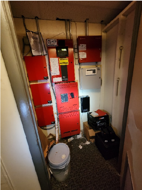
C-7: Fire room
